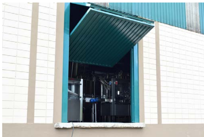
Imagem 06: estruturas para funcionamento da Adega Casa Geraldo - maquinário. Novembro de 2018. Bárbara Pereira Maçanares.
