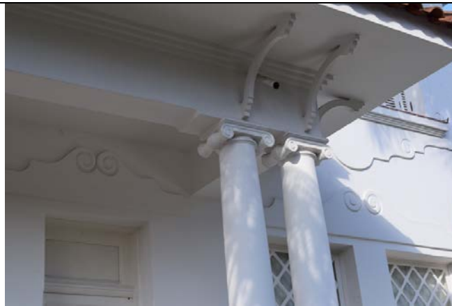
Imagem 08: Edificação localizada à Praça Alcides Mosconi – Casa do “Zé Barbosa” - detalhes. Novembro de 2018. Bárbara Pereira Mançanares.
