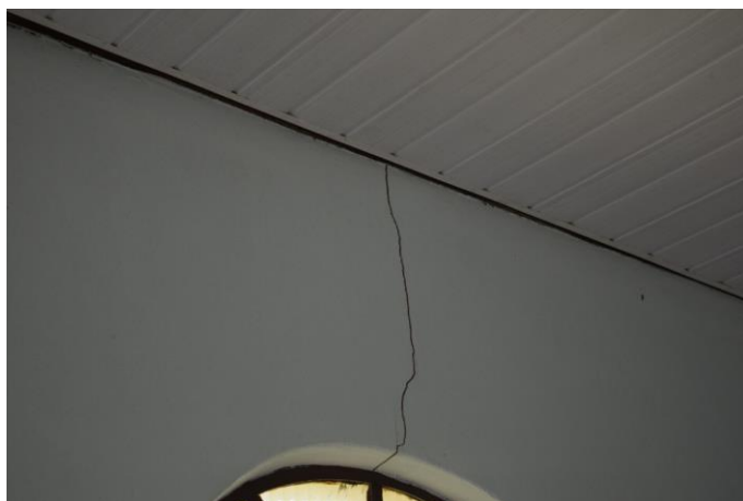
Imagem 11: Detalhe de uma rachadura no interior da capela. Fotografia de Jaíne Diniz Corrêa, dez/2023.
