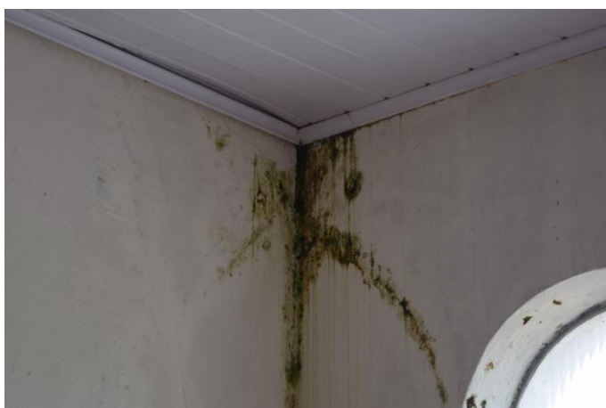
Imagem 12: Detalhe de infiltração no interior da capela. Fotografia de Jaíne Diniz Corrêa, dez/2023.
